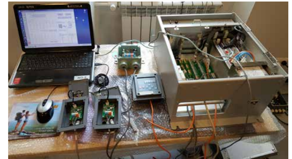
Программирование и ремонт РДР
