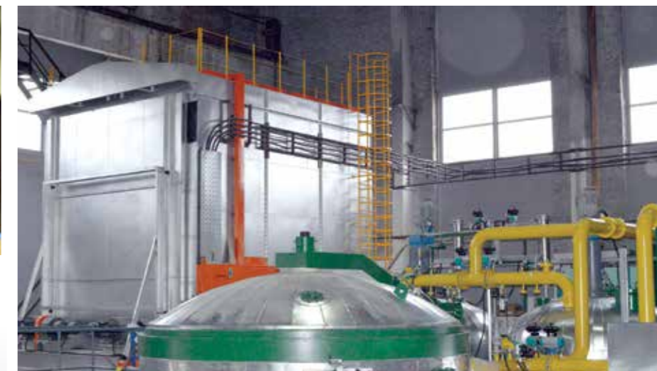
Вакуумно-нагнетательный пропиточный комплекс «Монолит» на «Ленинградском электромашиностроительном заводе»
