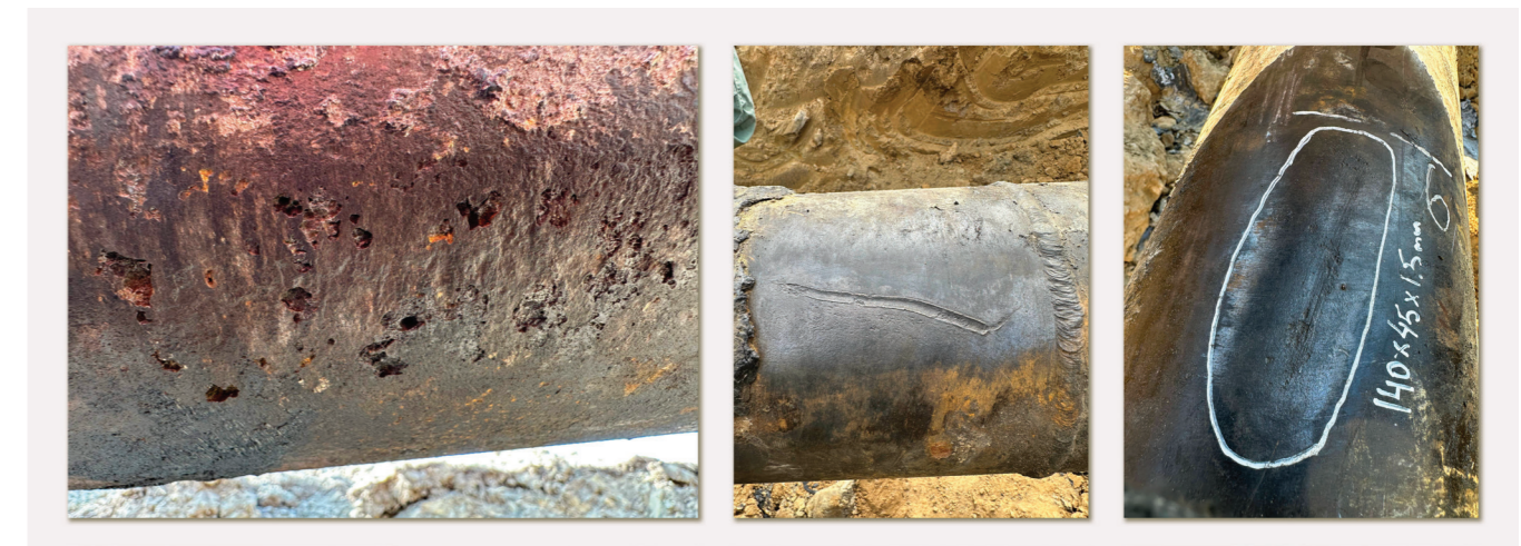
Рис. 3 Коррозия и механические дефекты подтверждены в шурфе, вскрытом по результатам МТМ-Градиент как аномалия, обусловленная изменением кольцевых механических напряжений
