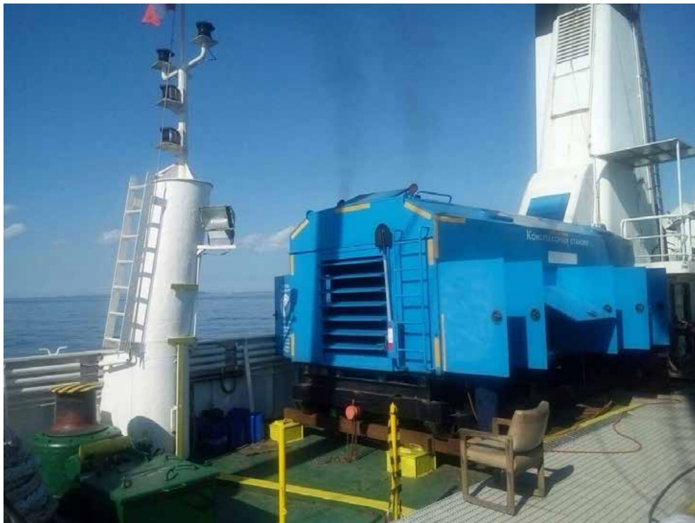
Компрессорная станция ТГА на судне
